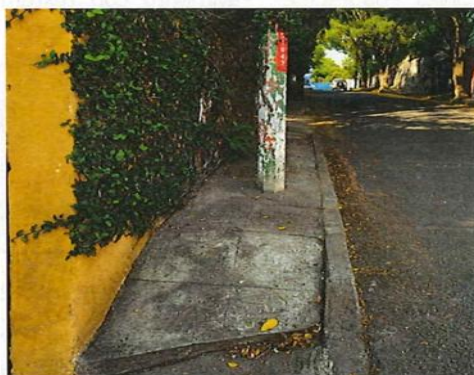
Cuernavaca, Morelos. Obstrucción de rampas con postes.
