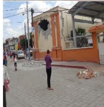
Figura 65. Afectaciones a inmuebles por el sismo de 2017.
