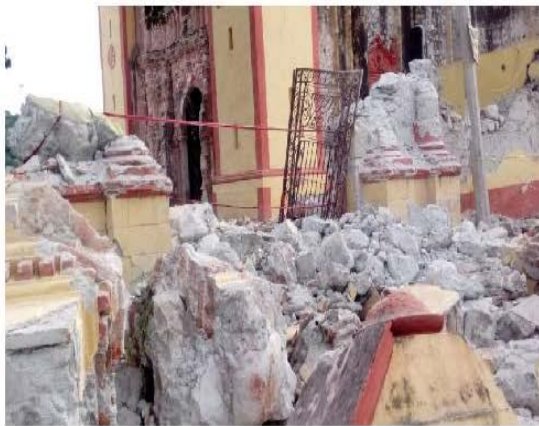
Figura 64. Afectaciones a inmuebles por el sismo de 2017.
