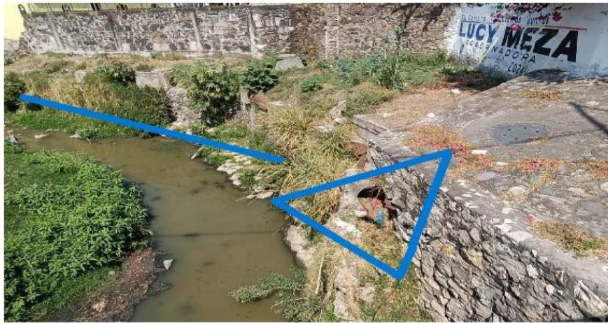
Colectores colapsados en la Barranca Apanquetzalco
